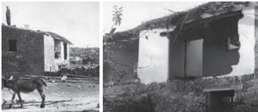
[034 y 035] Dos imágenes de la demolición de la casa familiar de Elisardo por parte de Iberduero debido a la construcción de la presa de Almendra en el vecino río Tormes (1967).
