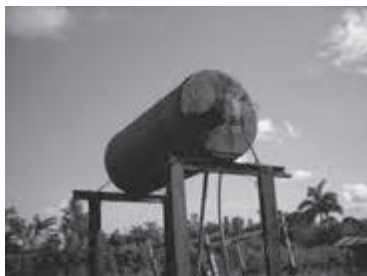
Tanque de agua elevado, que se llena por el método “carnero”, instaurado en 1940.
